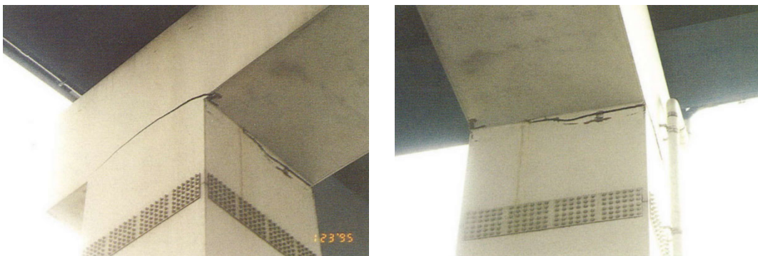
写真-1.1 鋼製橋脚隅角部に生じた脆性破壊の事例 2)
